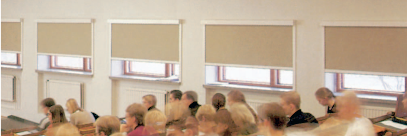
Sähkökäyttöiset ympärikoteloidut rullautuvat PV 80 -pimennysverhot. Kauppakorkeakoulu, Helsinki.
